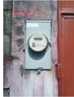
Limpieza de Main AC
