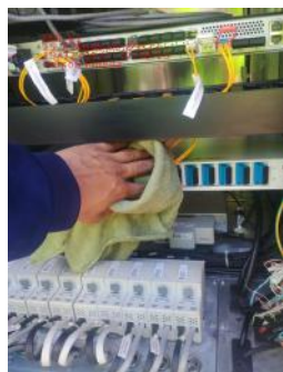
Limpieza general del equipo
